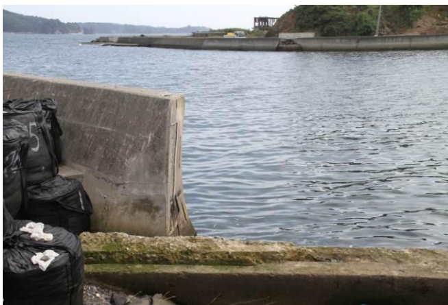
写真-3 防潮堤隅角部の損傷 I
