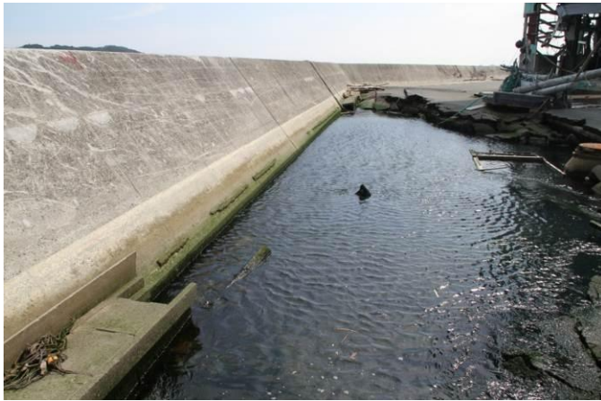
写真-1 防潮堤背後地の損傷
