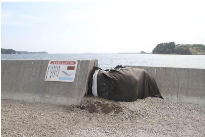
写真-5 防潮堤隅角部のずれ
