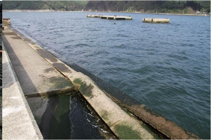
写真-2 防潮堤前部の損傷
