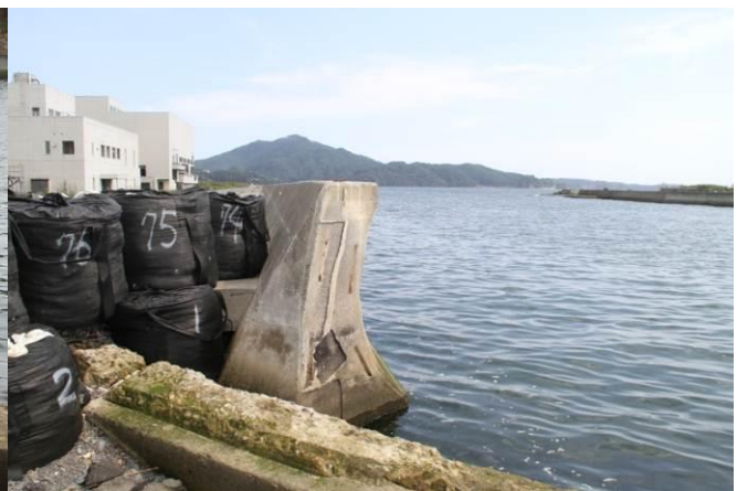
写真-4 防潮堤隅角部の損傷 II
