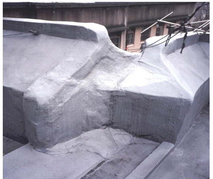
写真-2 パラペット部分 コンクリートのようなもので隙間を埋めている
