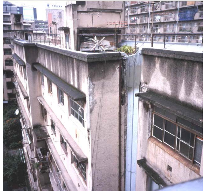
写真-1 同潤会アパートの外観 雁行する部分でずれが生じている
