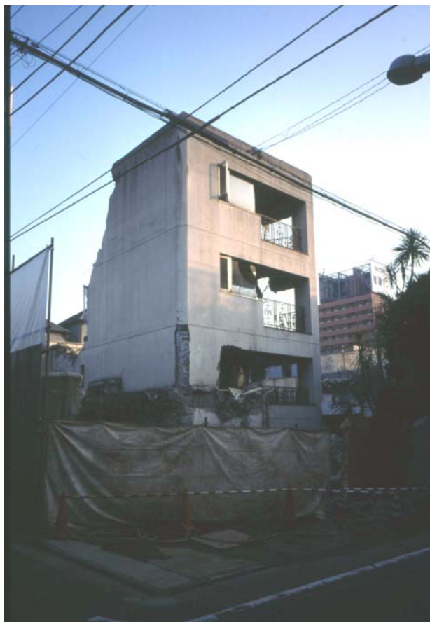
写真 1 解体される鉄筋コンクリート造建物。この土地には鉄骨造で小さな事務所用の建物が新築された。
